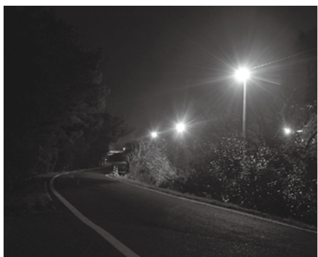
新塘に設置されたLED防犯灯
