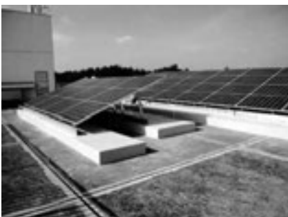
ソーラーパネル架台
