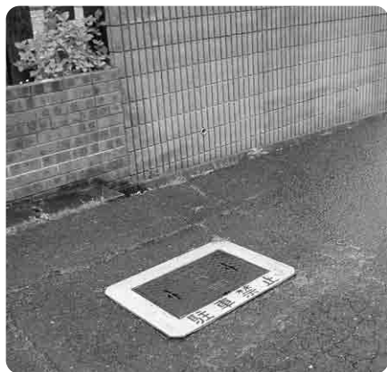
ホース、格納庫がない消火栓
