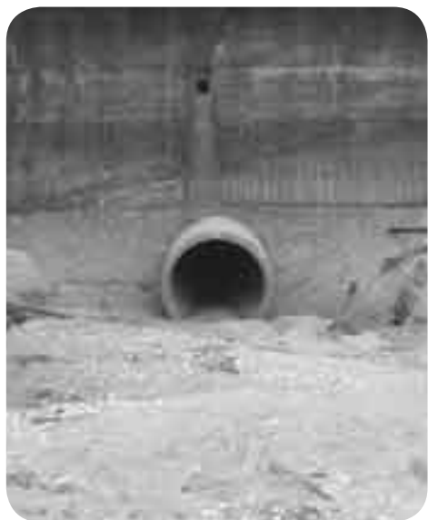
側溝へ逆流防止は万全か
