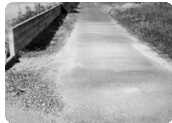
中心後退したブロック塀
