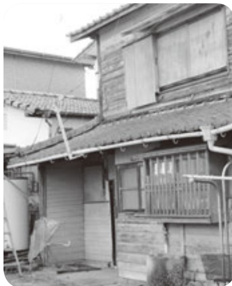
防災・衛生面・景観から対策が急がれる空家
