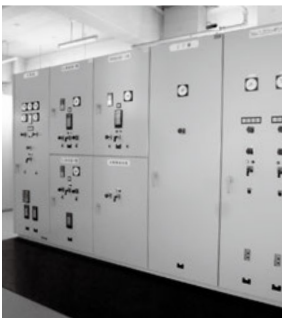
絶え間なく稼動する電気・機械設備
