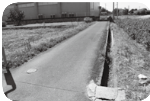
進まない道路改良 (脱輪注意!)
