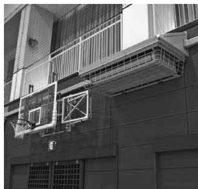
空調設備が整った長洲中体育館
