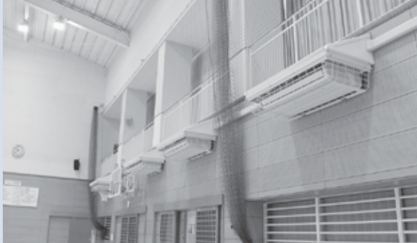
▲長洲中体育館に設置されたエアコン設備
