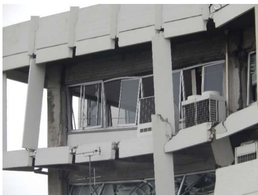
写真 2.1.5 庁舎棟の局部崩壊
