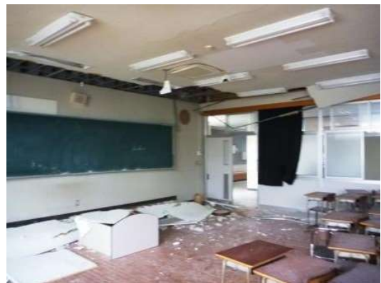
写真 2.1.4 天井の脱落（校舎）
