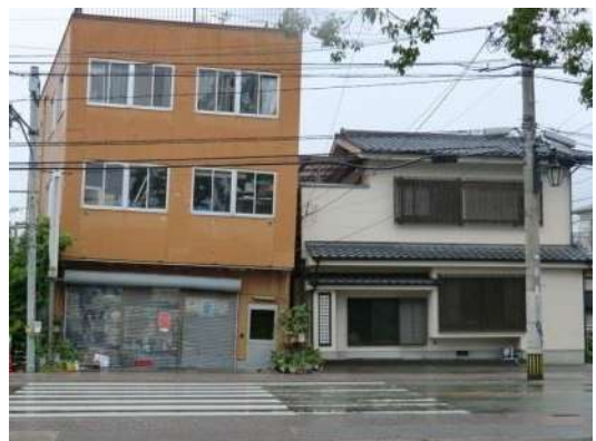
写真 2.1.6 液状化による建築物の傾斜
