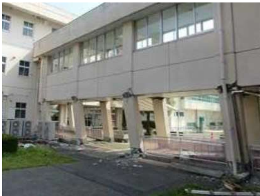
写真 2.1.3 渡り廊下の倒壊（校舎）
