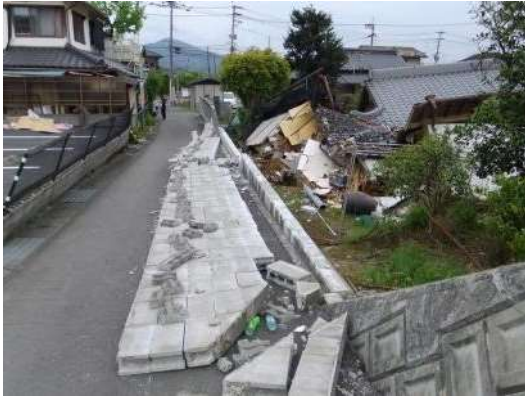
写真 2.1.7 ブロック塀の倒壊
