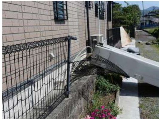
写真 2.1.8 給湯設備の転倒
