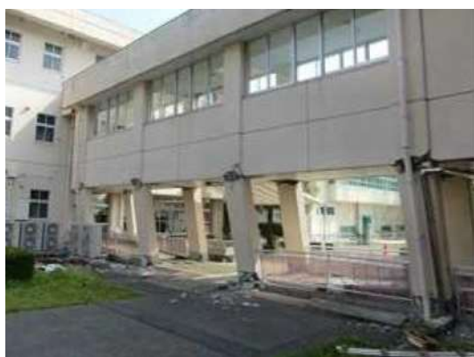
写真 2.1.3 渡り廊下の倒壊（校舎）
