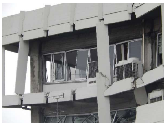
写真 2.1.5 庁舎棟の局部崩壊
