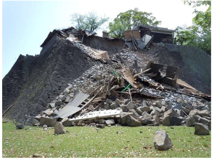
写真 1.1.1 平成 28 年熊本地震による被害
