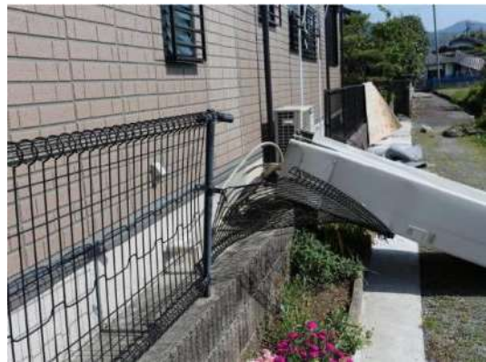
写真 2.1.8 給湯設備の転倒
