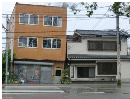
写真 2.1.6 液状化による建築物の傾斜
