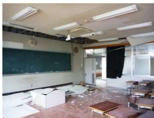
写真 2.1.4 天井の脱落（校舎）
