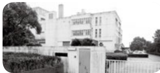
劣化・老朽化している浄化センター
