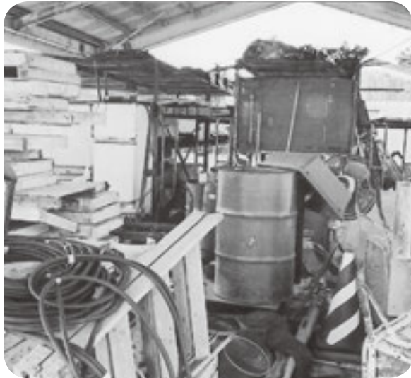
作業場の一部に置かれた建設資材 (平成25年3月撤去済)
