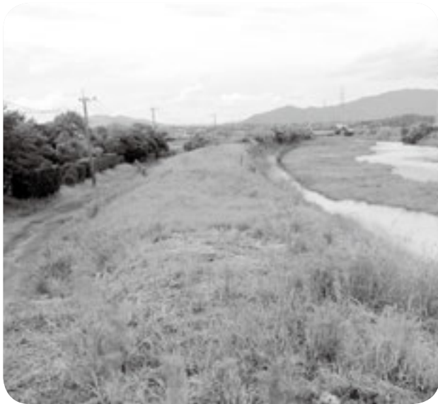
草木が生い茂っている堤防
