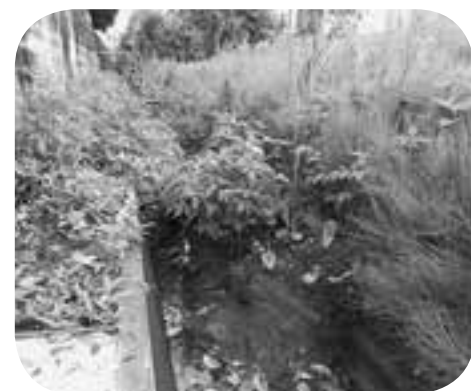
機能していない泥水路、ひらくち注意
