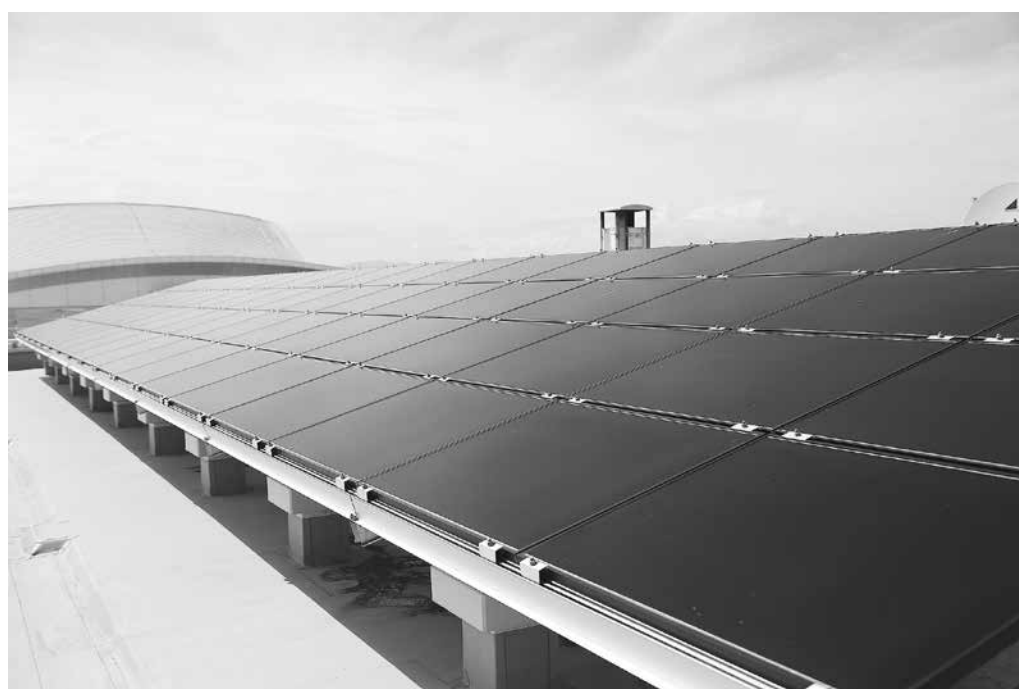
長洲町役場庁舎屋上に設置されている太陽光パネル
