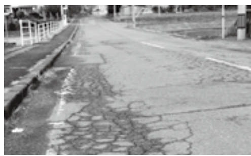
計画的な路面の修繕を進めよう
