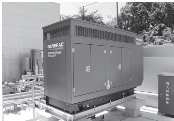
大容量の非常用発電機
