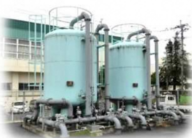
腹赤浄水場内（急速ろ過機）
