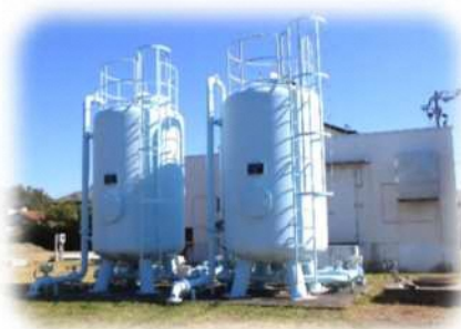
梅田浄水場内（急速ろ過機）
