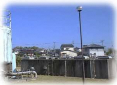
高田浄水場内（着水井）
