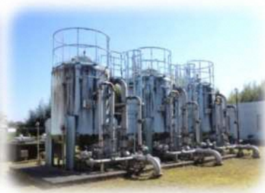
高田浄水場内（急速ろ過機）
