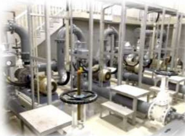
腹赤浄水場内（加圧ポンプ設備）
