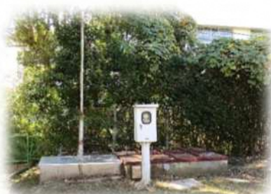
腹赤浄水場内（第3水源）
